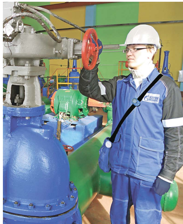
На насосной станции очистных сооружений ОС-129а идет процесс откачки иловой смеси
